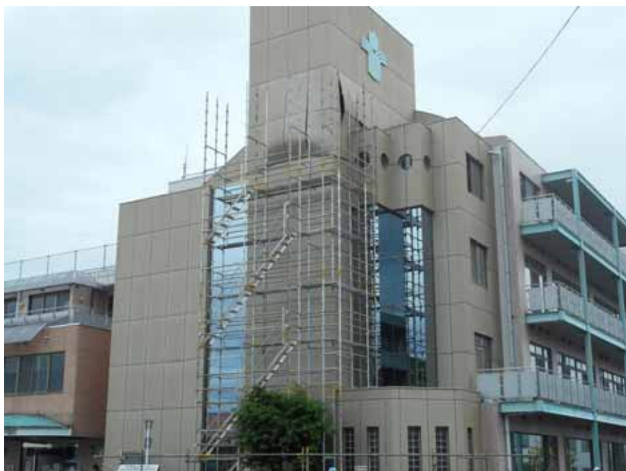
写真：熊本市尾ノ上にある「第二コスモピア熊本」修復工事の様子。周辺の道路も大きく歪み、完全な修復には時間がかかる。 (平成28年6月6日撮影)
